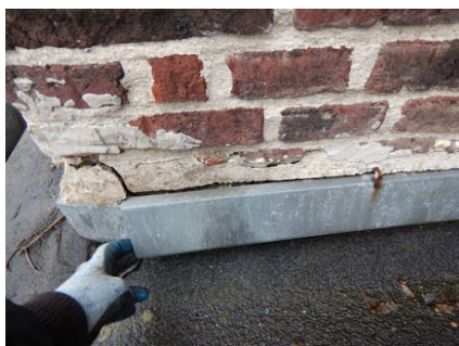
losse solin, afbrokkelend voegwerk, roeste solinhaak
