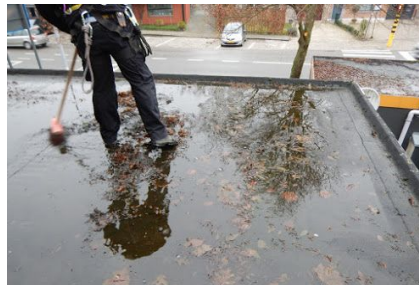
vervuild plat dak
