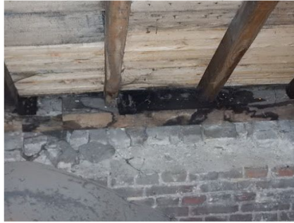
zuidwesthoek: lek muurplaat
