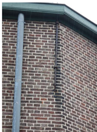
muuranker: zeer roestig (zuidzijde koor)
